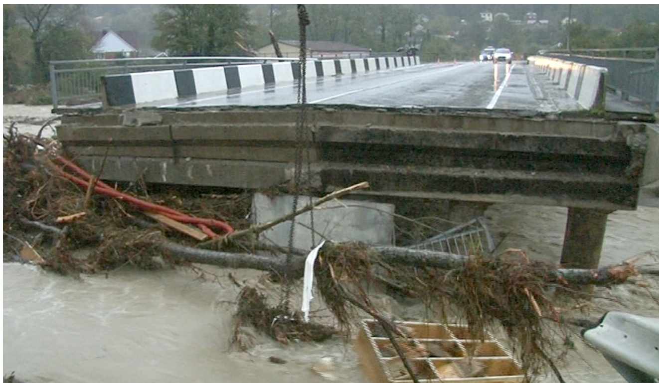
Рисунок 4. Карчеход и разрушенный паводком мост
